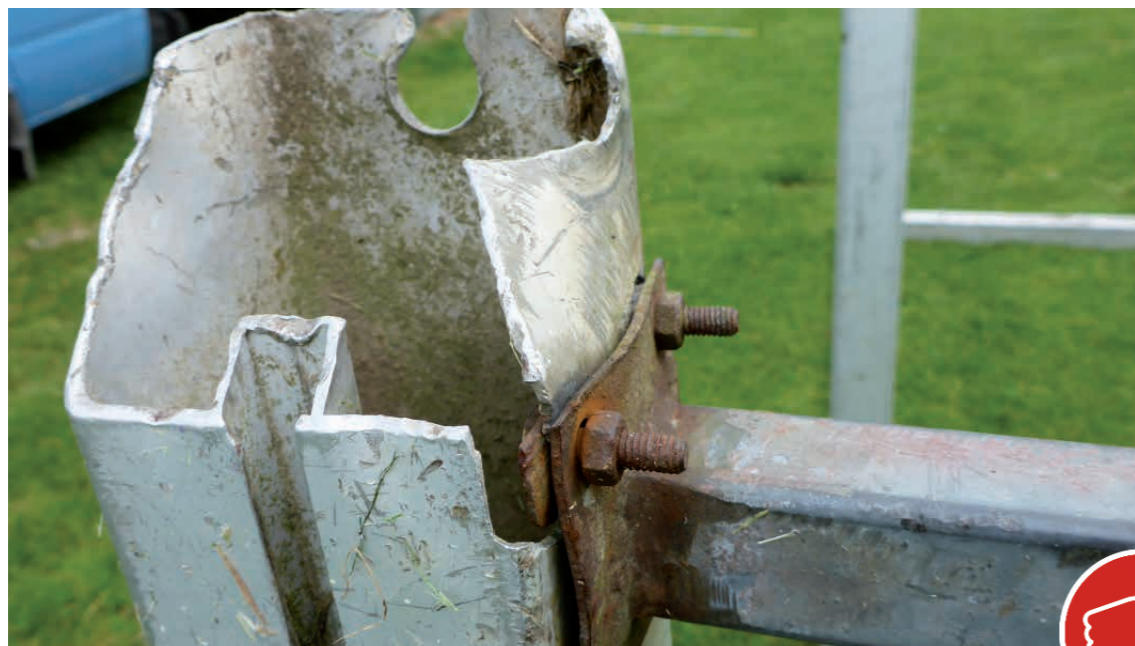
Bild 16: Überstehende Schrauben und scharfe Kanten stellen eine erhöhte Verletzungsgefahr dar.
